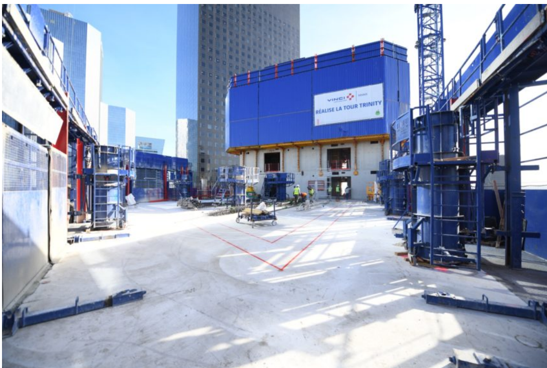
Le chantier de la tour Trinity est désormais à la mi-hauteur avec la réalisation du dix-huitième étage. Le noyau atteint lui le vingt-et-unième niveau. – Defense-92.fr
